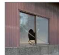
窓が割れた管理不全空家
