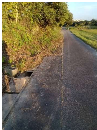
鋼製側溝蓋盗難状況
