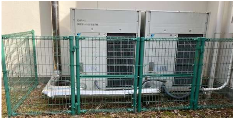
北側室外機フェンス
