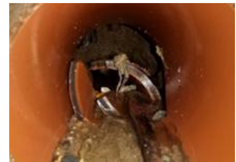
破損による閉塞
