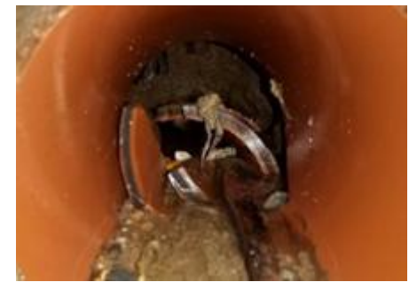
破損による閉塞
