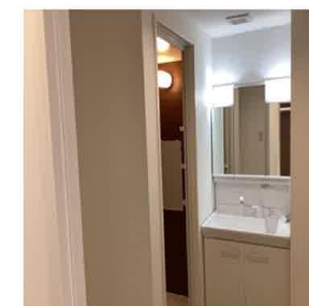
洗面設備の改良
