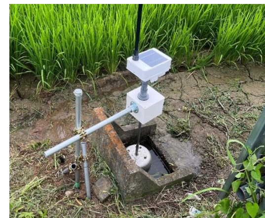
【水位センサー及び給水バルブ】
