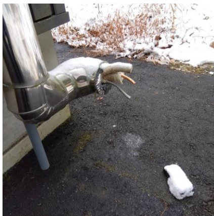
エアコン室外機の盗難状況 (被害状況)
