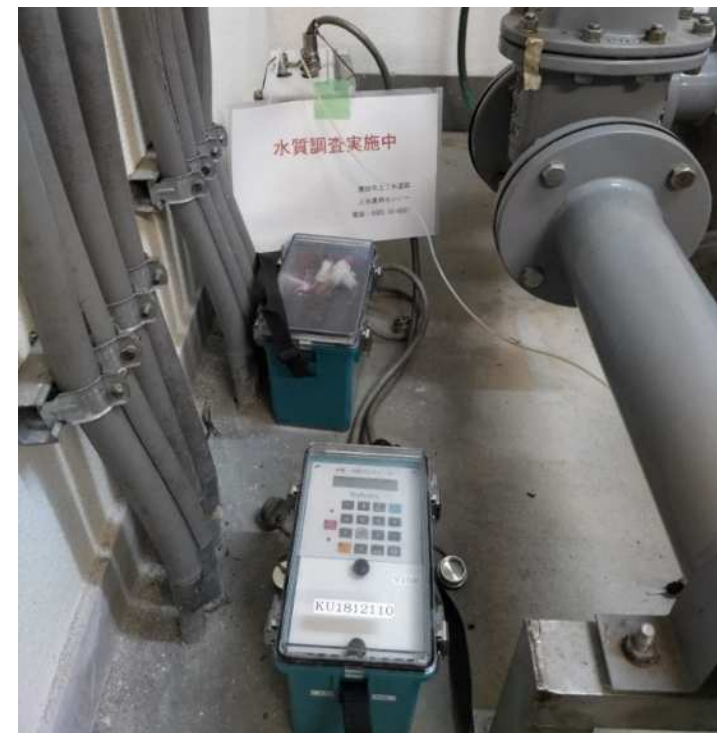
配水場に設置した実証実験機器
