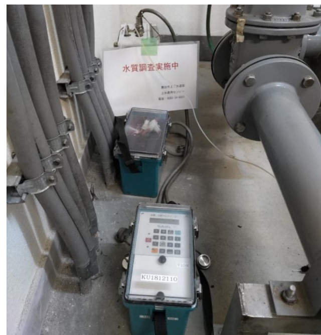
配水場に設置した実証実験機器
