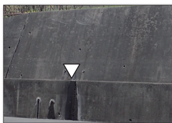
地下水の流出
