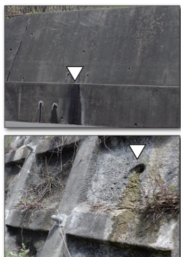
地下水の流出
