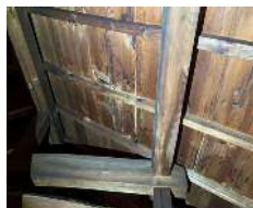
雨漏りによる 野地板や垂木の腐食
