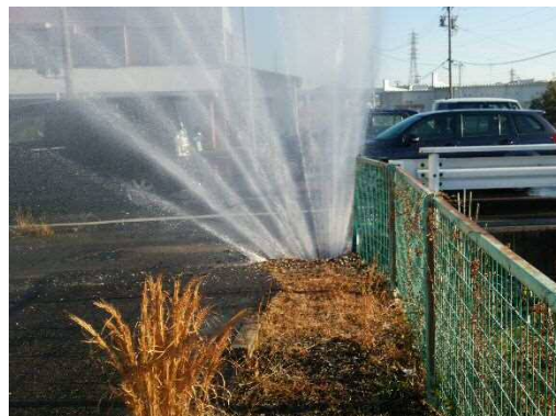
水道管の破裂
