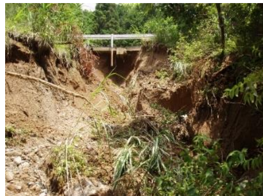
排水施設の閉塞による林道被害
