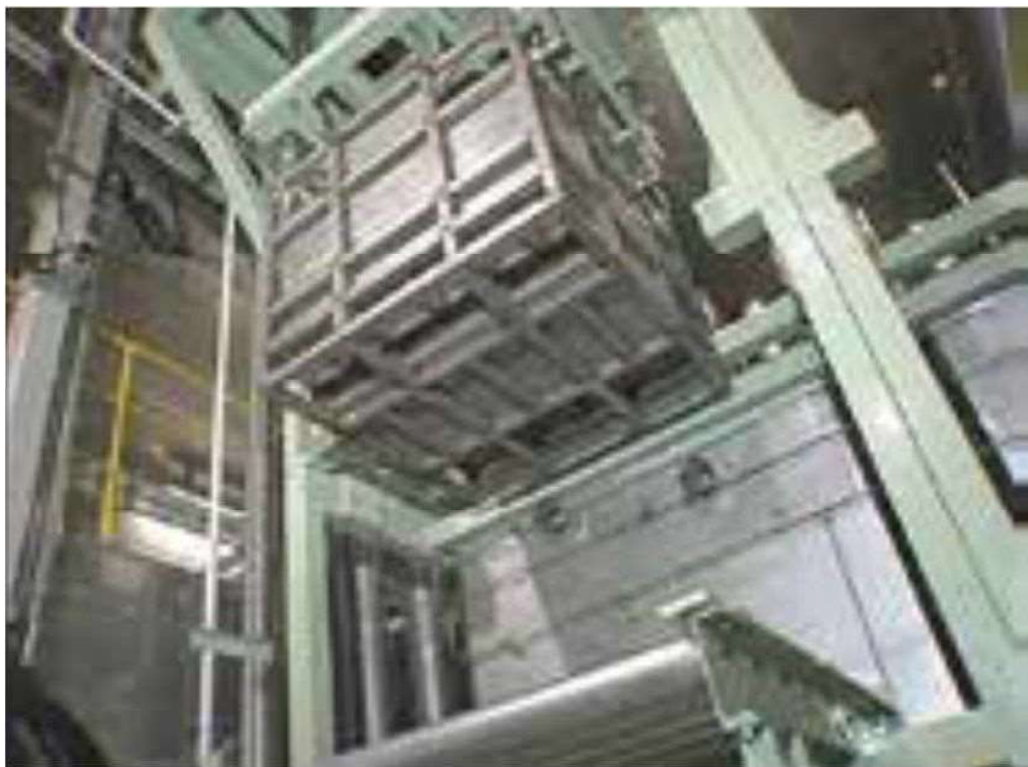
洗浄カゴと 真空超音波洗浄設備
