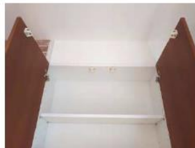
吊戸棚等の地震対策措置
