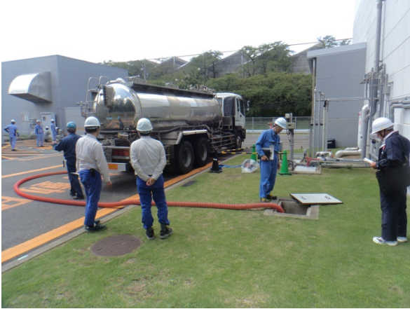
【R1.9.2 放流水油分異常の確認】
