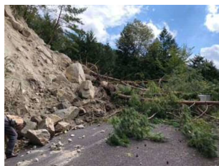
<平成30年7月豪雨災害によるがけ崩れ 稲武地区の林道沿い>
