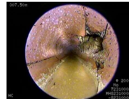
管内の破損状況 (管路TVカメラ調査)
