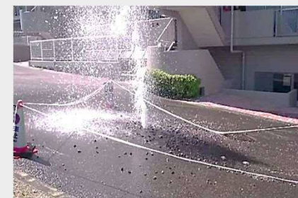
老朽化した水道管破損による漏水
