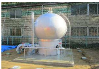
飲料用耐震性貯水槽（旭地区）
