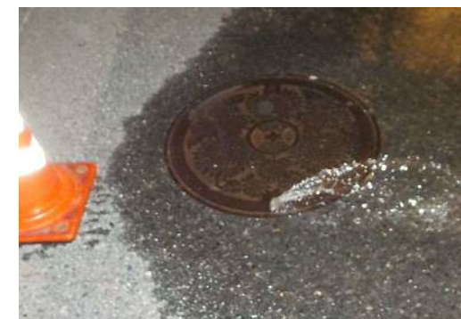
管路閉塞により溢水しているマンホール
