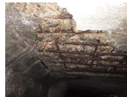
管路施設包括的維持管理委託の調査により発見された老朽化した下水道の雨水管路
