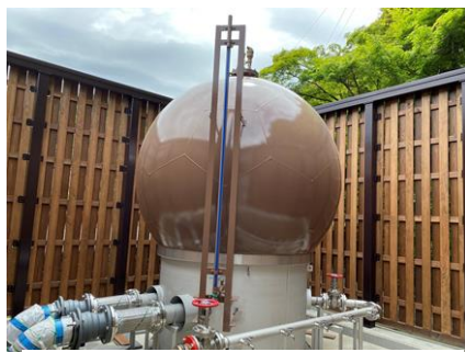
飲料用耐震性貯水槽（足助地区）
