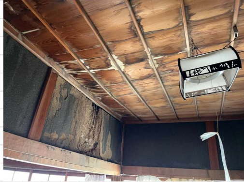
【2階和室 6帖①（雨漏り）】
