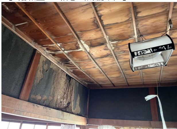
【2階和室 6帖①（雨漏り）】
