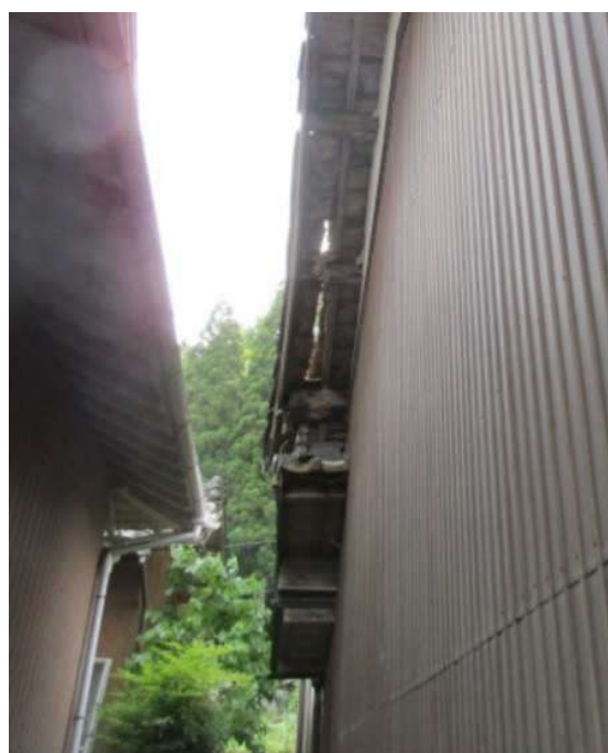
外観 屋根崩壊箇所
