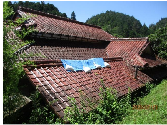
居宅裏側1（屋根破損有）
