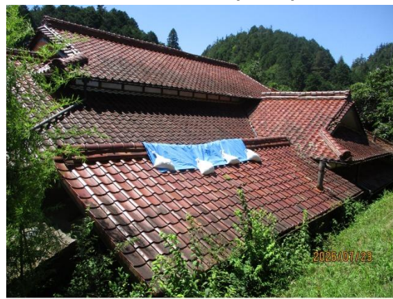
居宅裏側 1（屋根破損有）
