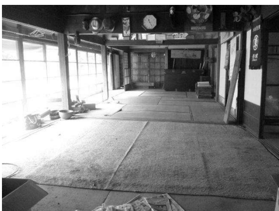
和室（床板の沈み有）
