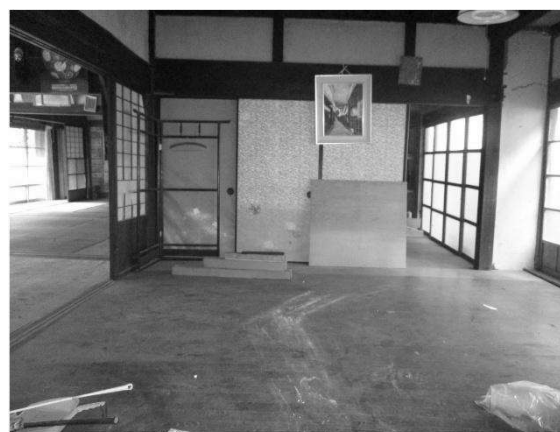
洋室 1（壁に亀裂有）
