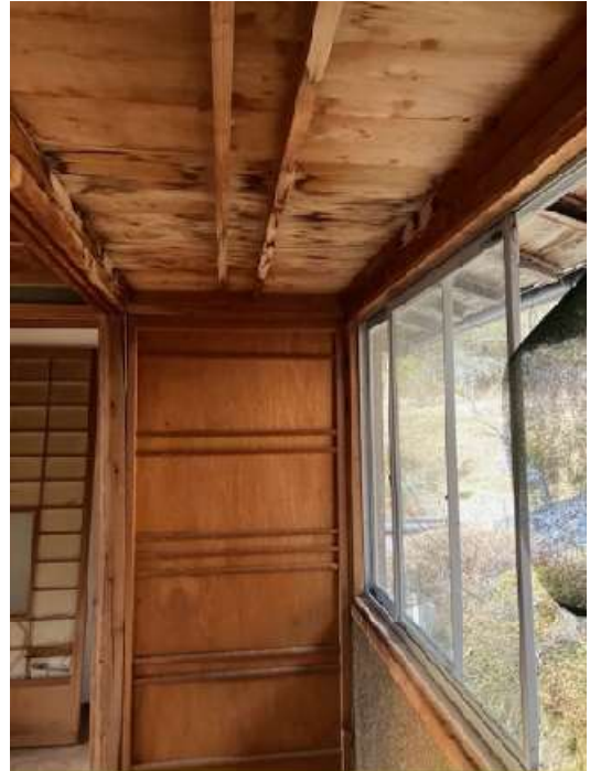
2 階廊下 (雨漏り跡あり)
