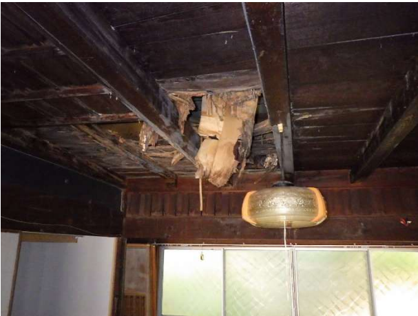
床の損傷部分
