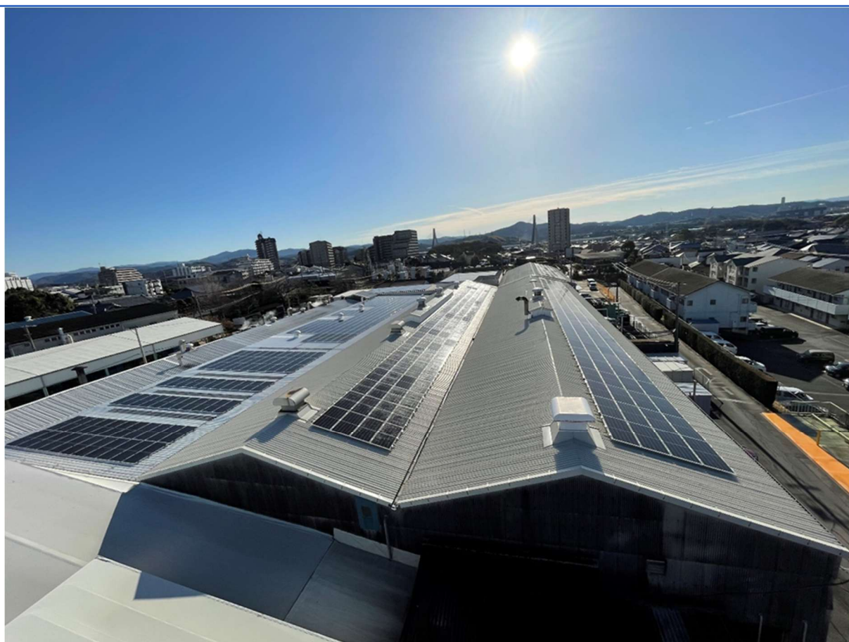
太陽光パネルを設置した工場の例
