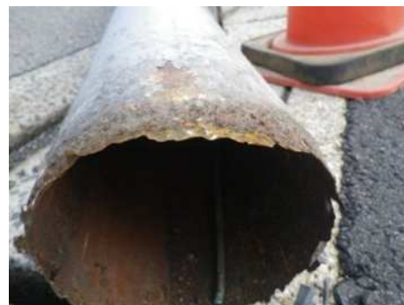
写真-6.8.2 腐食した照明柱基部断面
