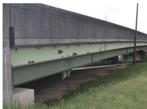
写真-6.2.3 修繕前 (主桁の腐食)
