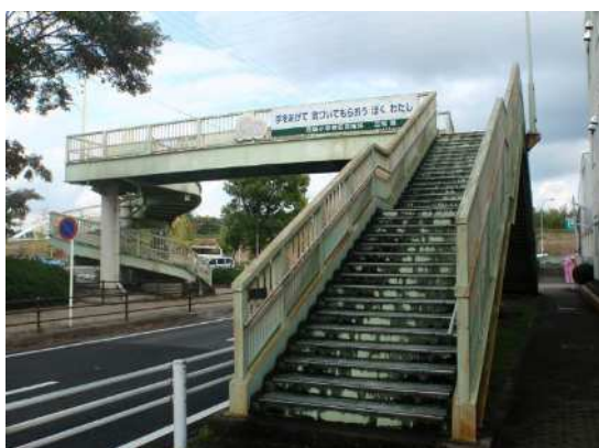
写真-6.3.3 修繕前 (主桁の腐食)
