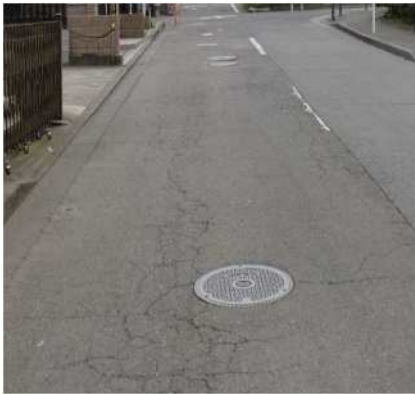
ひび割れ率 40%超
