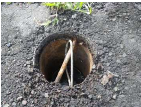
写真-6.8.1 照明柱基部腐食状況
