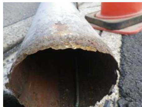
写真-6.8.2 腐食した照明柱基部断面
