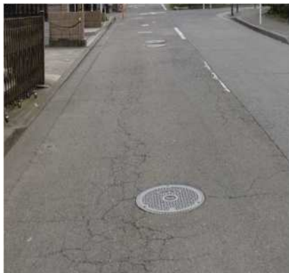
ひび割れ率 40%超
