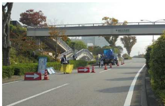
写真-6.3.2 道路の規制状況
