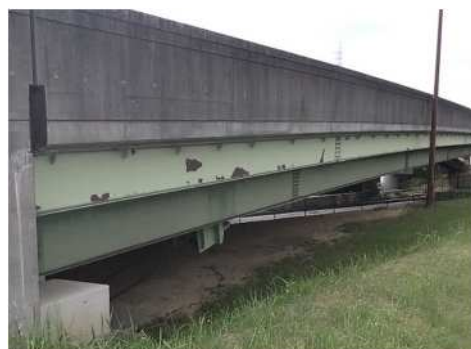
写真-6.2.3 修繕前 (主桁の腐食)
