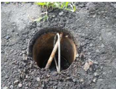
写真-6.8.1 照明柱基部腐食状況
