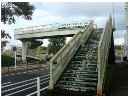
写真-6.3.3 修繕前 (主桁の腐食)
