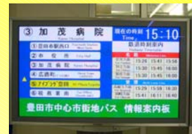
施設内に設置した運行情報板 (バスロケーションシステム)
