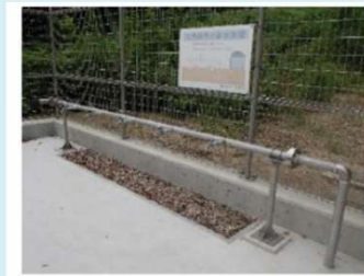
<災害拠点給水施設>
