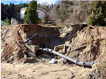
浄水場内の配管損傷 (七尾市)
