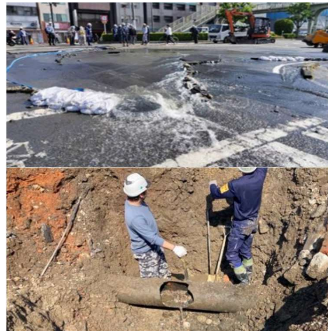
(令和7年4月 京都市 老朽管路の漏水) 出典：国土交通省 京都市下京区における水道管漏水事故と今後の対応
