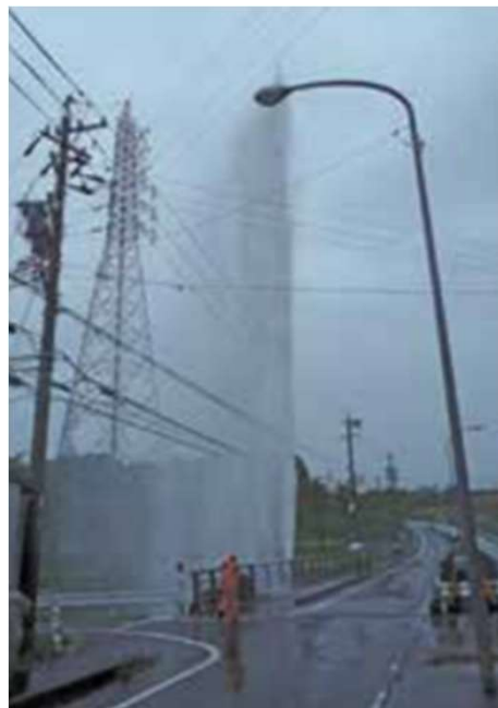
(空気弁破損による漏水)
