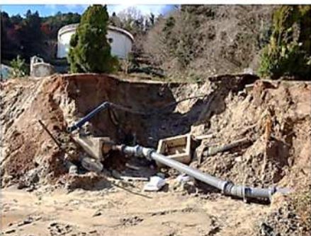
浄水場内の配管損傷 (七尾市)
