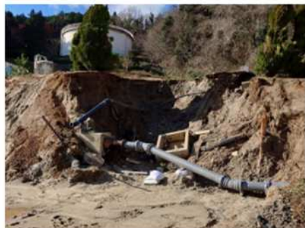
浄水場内の配管損傷 (七尾市)
