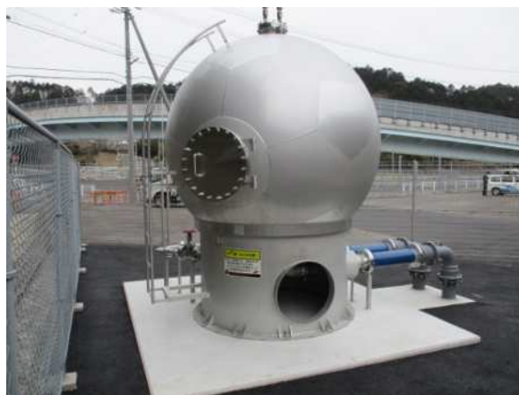
応急給水施設
