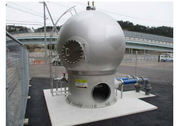
応急給水施設
