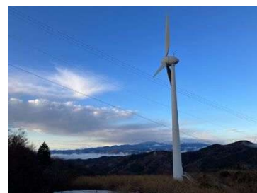
面ノ木風力発電所 (令和7年11月撮影)
