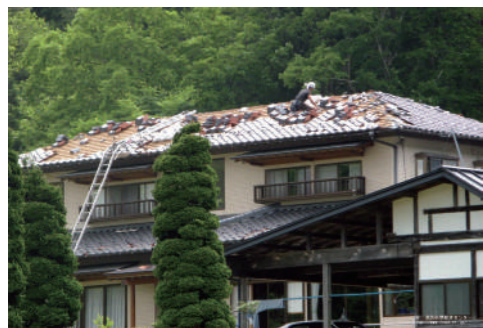
屋根瓦の落下被害
