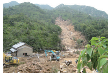
土砂災害現場
