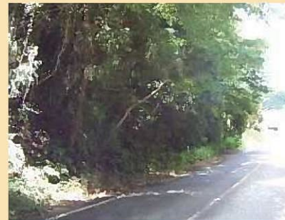
平成12年東海豪雨 被害箇所①
