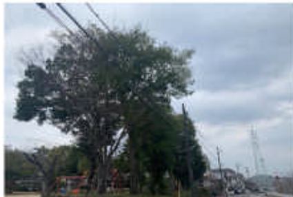
電線に掛かる枝折れて停電する前に予防保全
