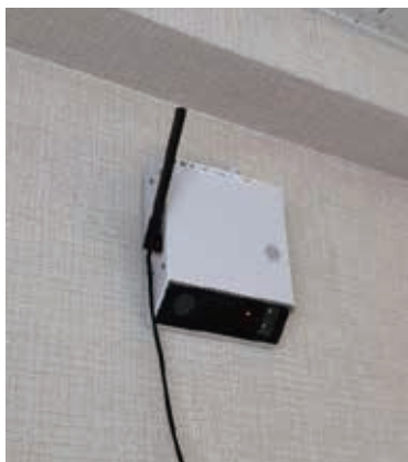
機器設置の様子
