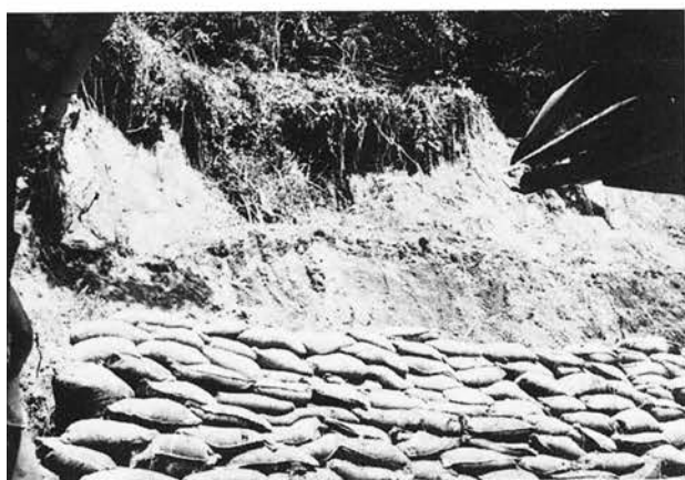
清原小学校給食室裏山の崩壊
