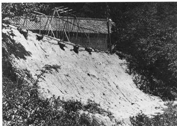
崩壊した福原小学校運動場土手
