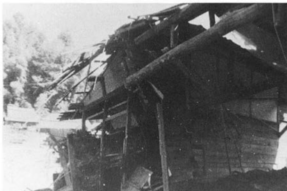
崩壊寸前の製材工場 栄区 下仁木
