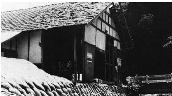
土台下を洗われた大ヶ蔵連公民館
