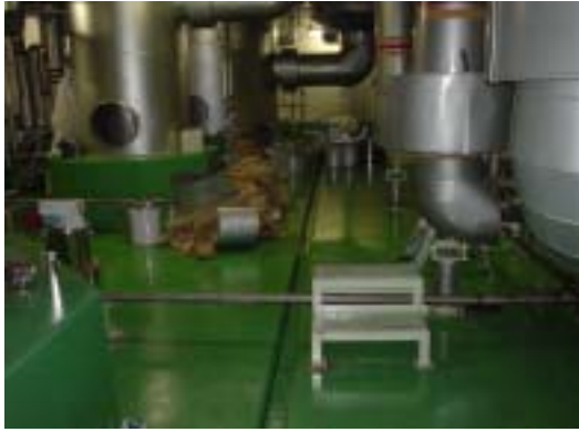
漏洩場所（蒸留エリア）
