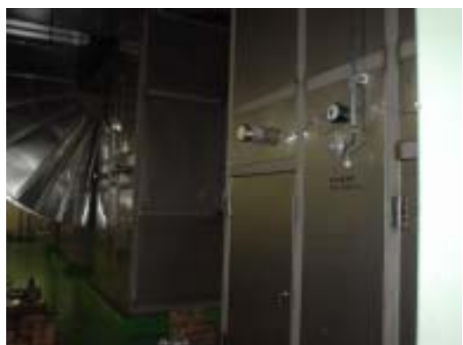
活性炭吸着槽
