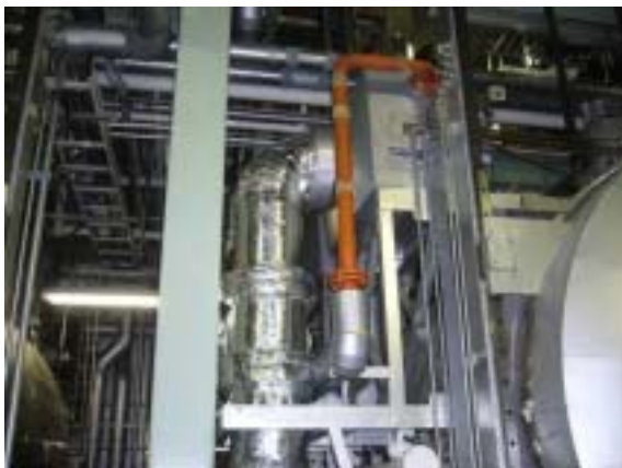
保温材を剥がした熱交換器
