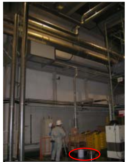
-4 受入エリアの漏洩箇所 （漏れは缶にて回収）
