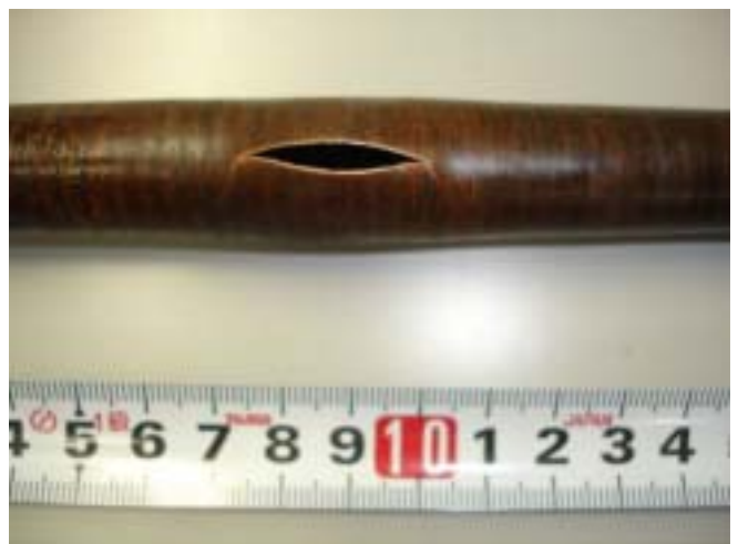
-6 熱交換器破損配管
