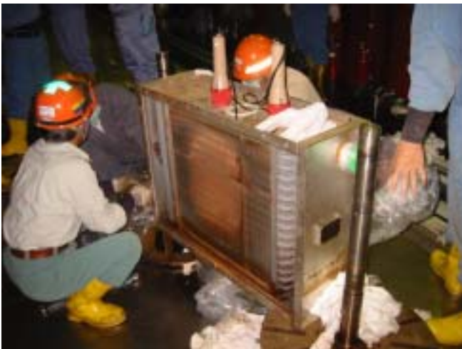
-3 専門業者による熱交換器点検
