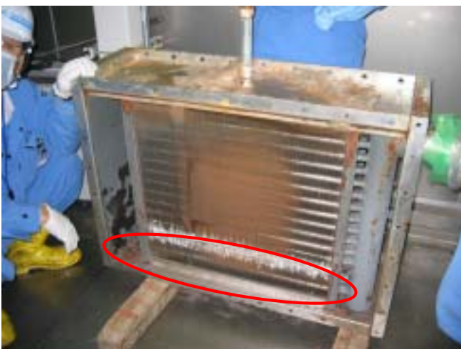
-5 熱交換器の内部（管を抜いた後）
