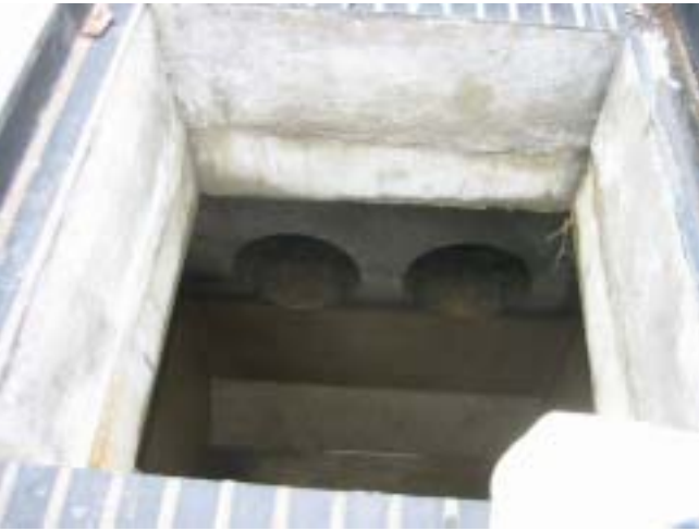
1- : 油水分離槽（施工ミス）
