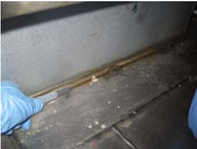
コーキング未施工箇所
