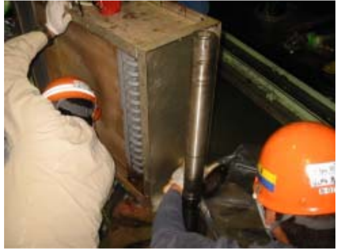
専門業者による熱交換器の確認作業
