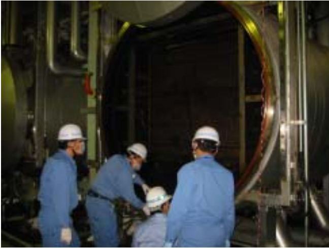
真空加熱炉 C の状況確認
