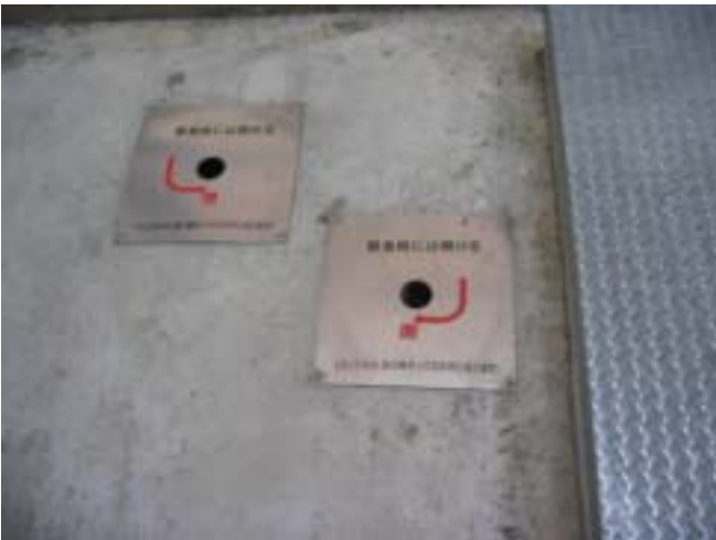
非常用溜枡の切換箇所
