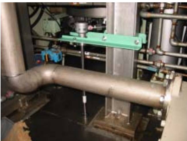
追加された漏洩検知器
