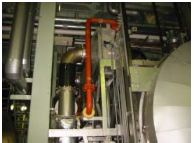
新規に設置された熱交換器
