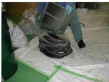
(4) 廃活性炭取り出し→ドラム缶保管 (廃活性炭保管倉庫)
